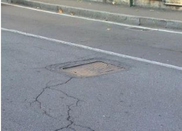
Dissesti e avvallamenti in prossimità dei chiusini [4]
